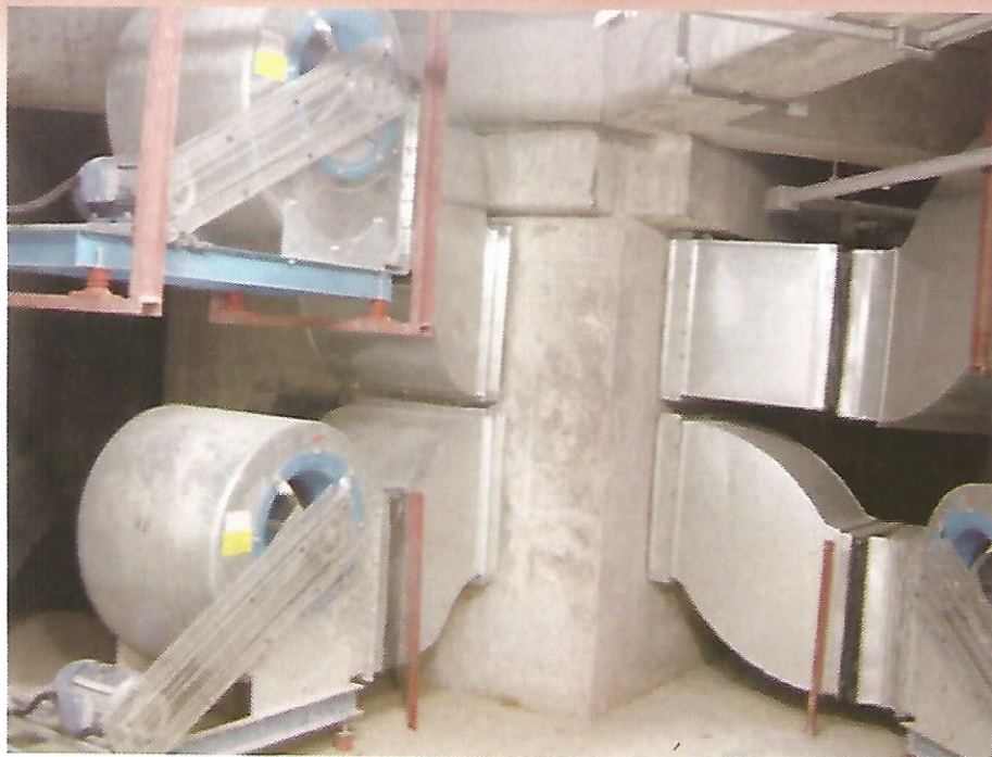
Detalhe típico de casa de máquinas do sistema de pressurização
